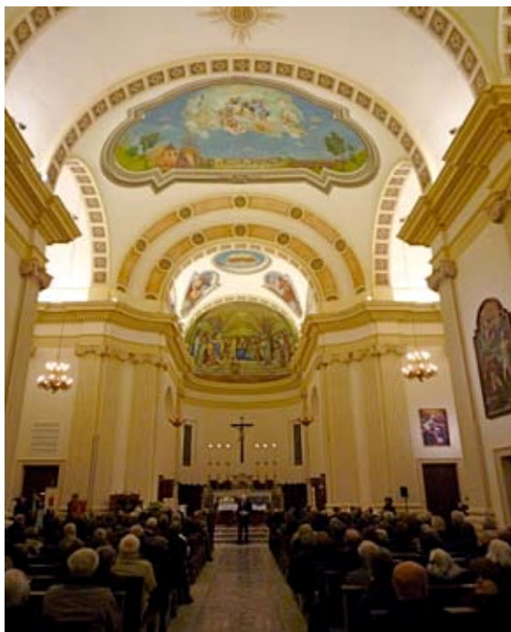
Dopo due anni di lavori di restauro la Chiesa parrocchiale di San Martino di Peschiera ha riaperto ai suoi fedeli
